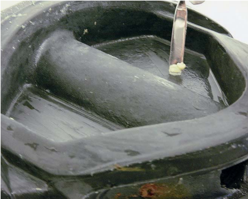
Abb. 6 Makroskopisch sichtbarer Biofilm auf gummibeschichtetem Absperrschieber (mit Spatel abgetragen, um Belagsdicke zu demonstrieren).
