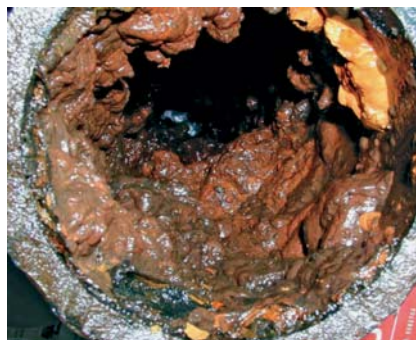
Abb. 1 Innere Oberfläche eines Graugussrohres (seit 99 Jahren in Betrieb), liefert hygienisch einwandfreies Wasser.
