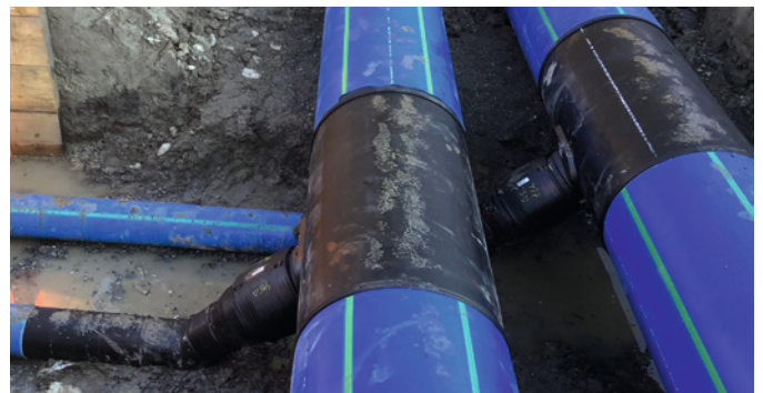
Sicher und effizient: Mit werkseitig-fabrizierten T-Stücken lassen sich Abzweige im Graben einfach, schnell und zuverlässig herstellen.
